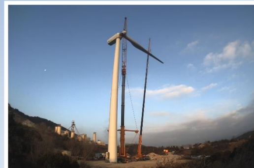
Repowering éolienne de CENTERNACH Département : Pyrénées orientales (66) Puissance électrique : 2,3 MW 1 éolienne Mise en service : 2018
